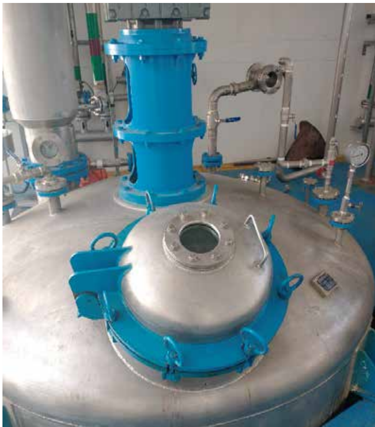
TANQUES DE AGITACIÓN Y CONTROL INDUSTRIAL
