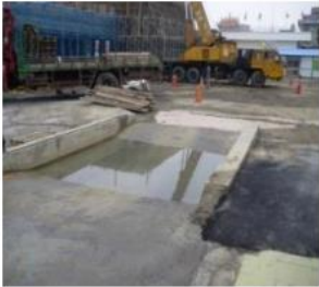
污泥沉澱過濾池
