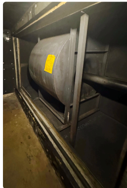
Old Fan System
