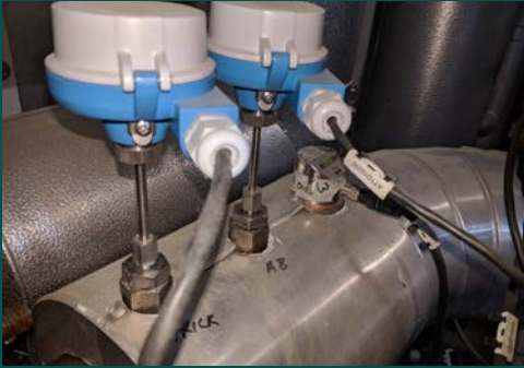
Danone Balclutha Chiller Optimisation
