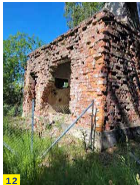
12 Rester av transformertorkiosken
