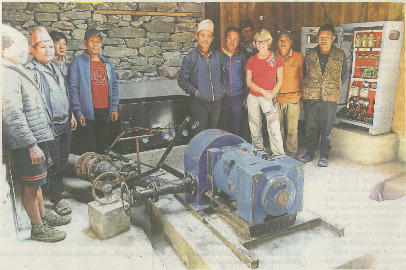
Im Powerhouse in Chepel: Isabelle Buschulte (Dritte von rechts) mit dem Ingenieur- und Bauteam.
