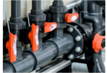
Sistemas de tuberías +GF+ Piping Systems (Georg Fischer), fitting, válvulas mariposa, instrumentos y accesorios en C-PVC para planta de osmosis inversa.
