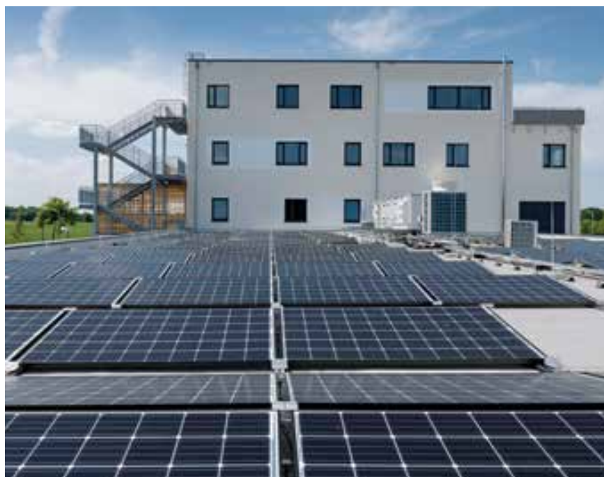
Photovoltaikanlage, Nieren- und Diabeteszentrum, Viersen
