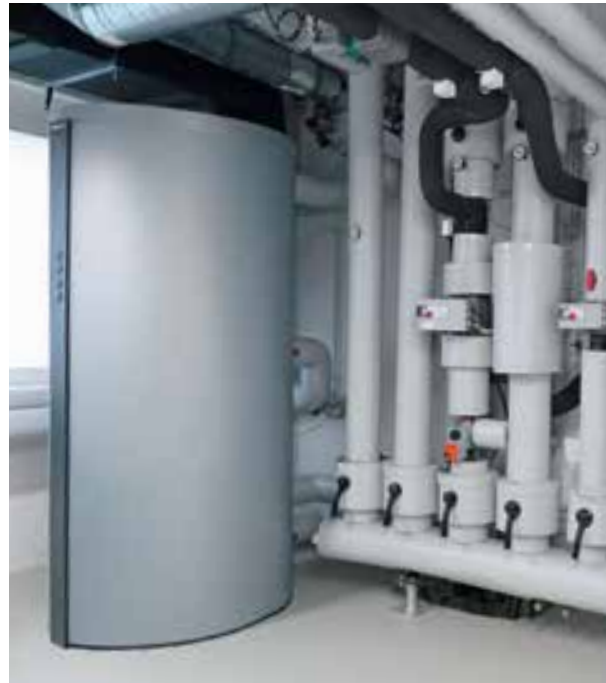
Erdwärmeheizung und -Klimatisierung, Bürogebäude KLEUSBERG, Wissen
