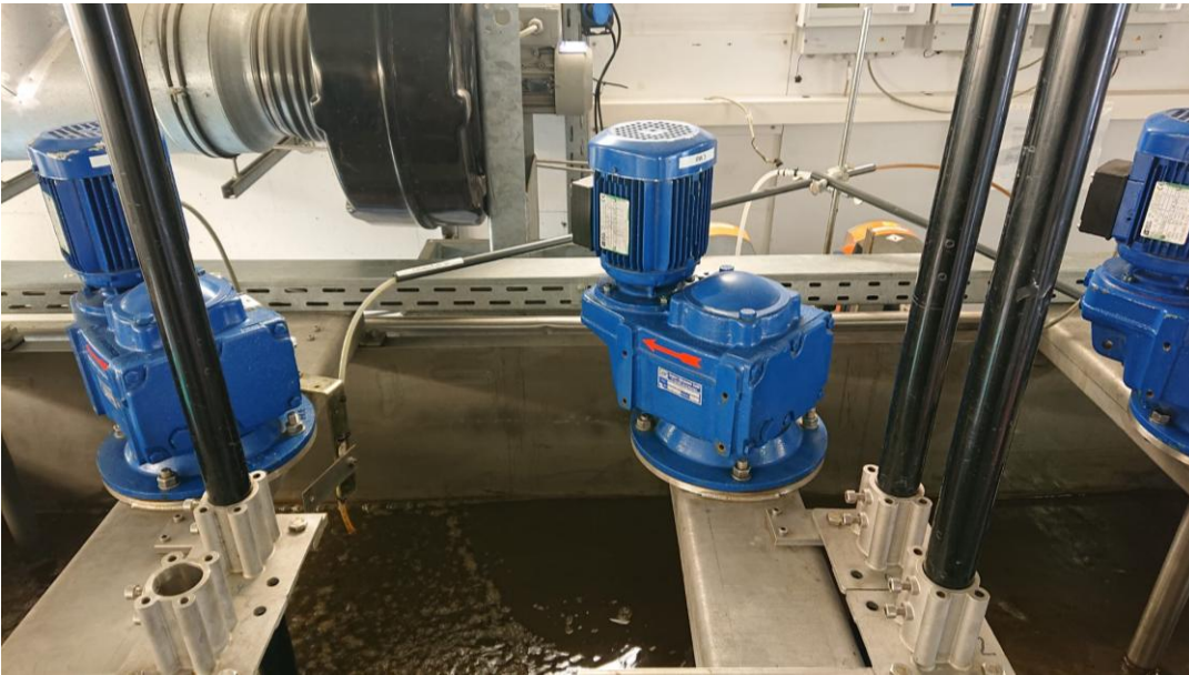
Fällmitteldosierung der HTVA der TUD auf der Kläranlage Dresden Kaditz
