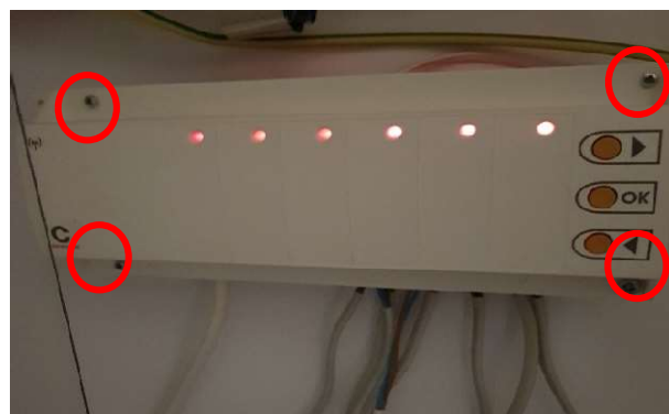
Bilde 1: Styringssentral for gulvvarme
