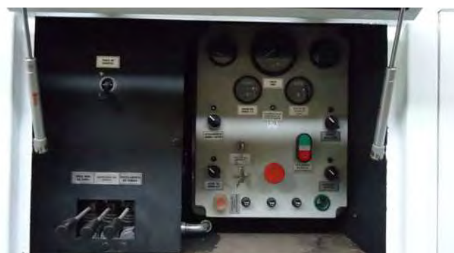
Comandos de operação do Sistema de Hidrojateamento
