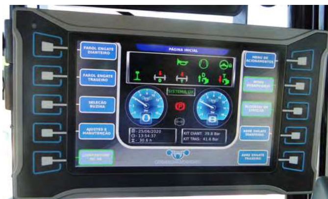
Aspecto parcial da vista do monitor IHM para o operador de dentro da cabine
