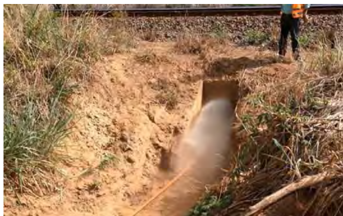
Bueiro obstruído, antes do início da limpeza com hidrojateamento
