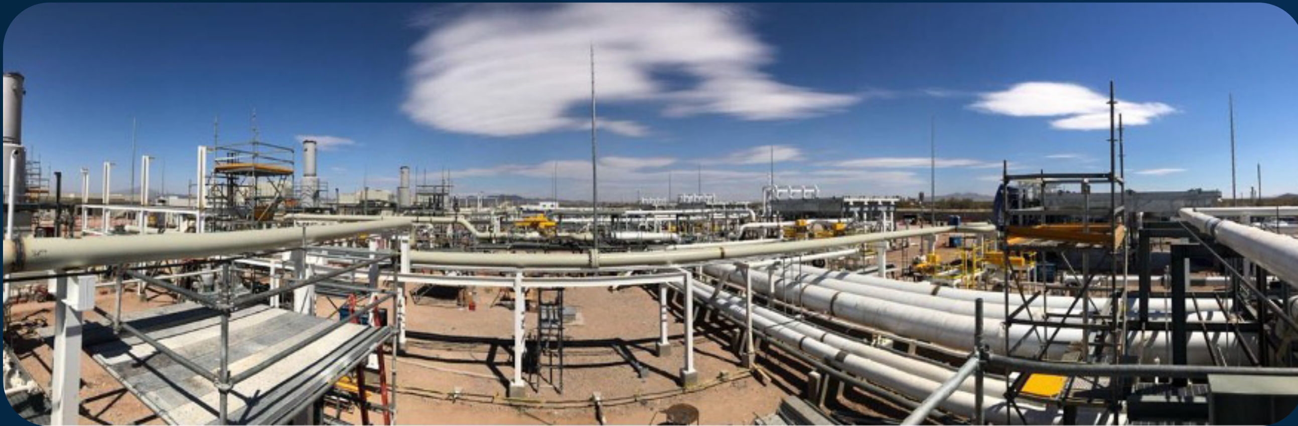
Estación de Rebombeo de Gas Pitiquito, Sonora.
