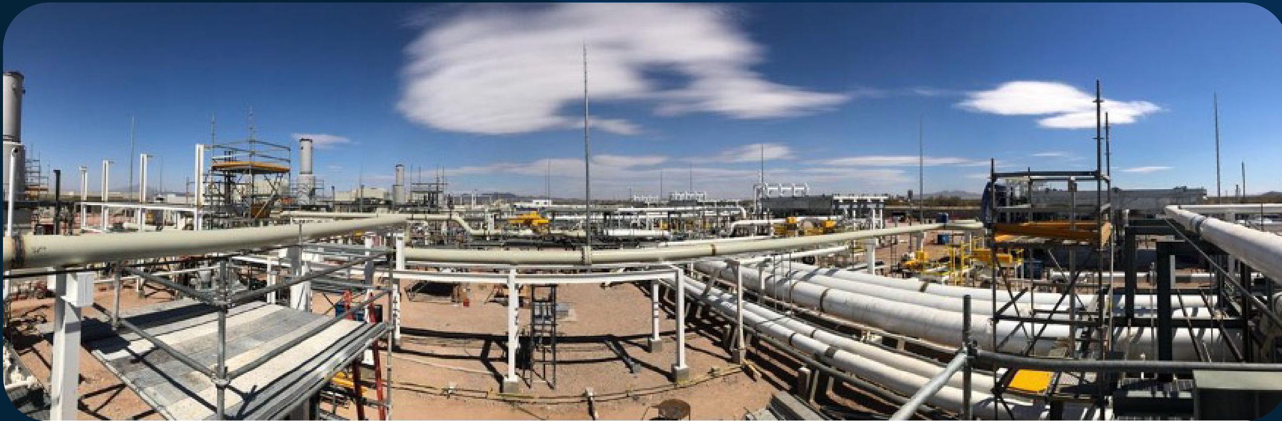
ESTACIÓN DE REBOMBEO DE GAS PITIKUITO, SONORA
