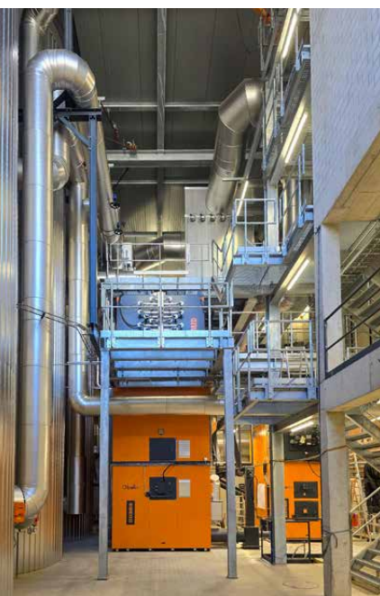
Einblick in die Zentrale des Energieverbunds Schaffhausen Ost.
