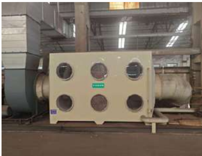
浙江寶綠特廢氣處理裝置
