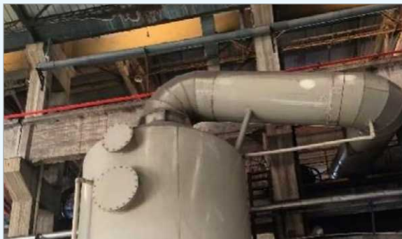
浙江寶綠特廢氣處理裝置
