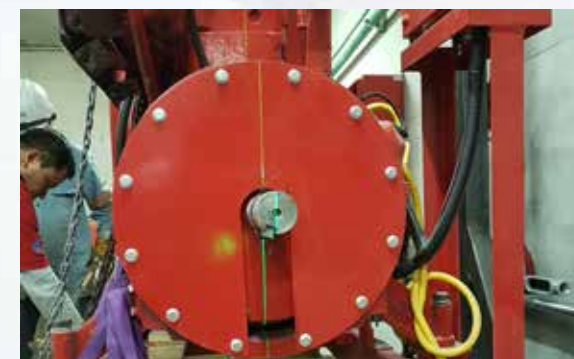
Alineación de eje de motor impulsor con eje de bomba contra incendio.
