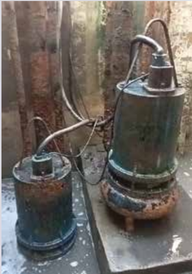
Bombas a reemplazar.
