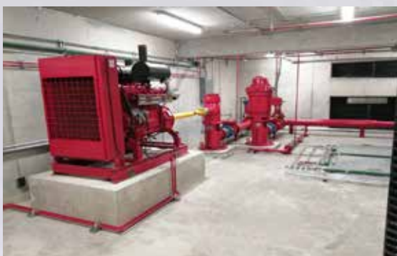
Equipo con bomba vertical multietapas en edificio de altura.
