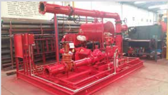
Etapa final de integración de equipo normado bajo requerimientos NFPA.
