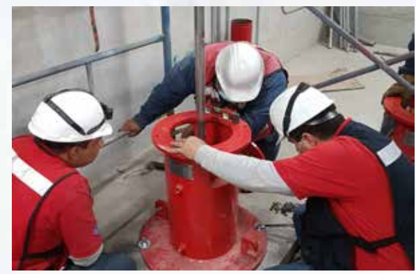
Instalación de columna de tazones de bomba vertical contra incendios.
