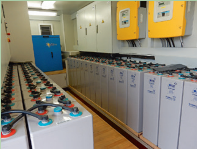
Neue Batterien wurden installiert. Seit Ende Februar liefert unsere Solaranlage wieder die Energie für den Betrieb des Waisenheims und der Primarschule.
