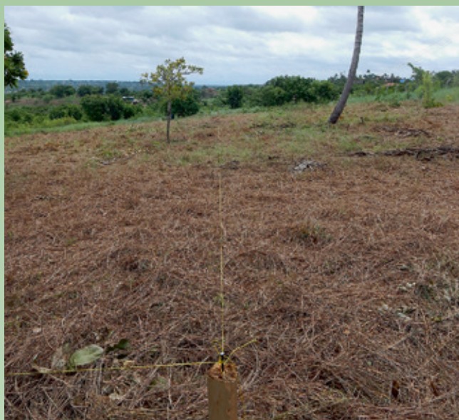
Das Schnurgerüst markiert die Position der ersten Gebäude der zukünftigen Lehrlingswerkstätte. Die heftigen Niederschläge im April verunmöglichten uns den Aushub.
