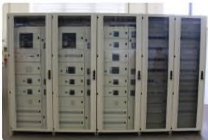
Tipologico quadro generale di bassa tensione con porta a vetro offuscato
