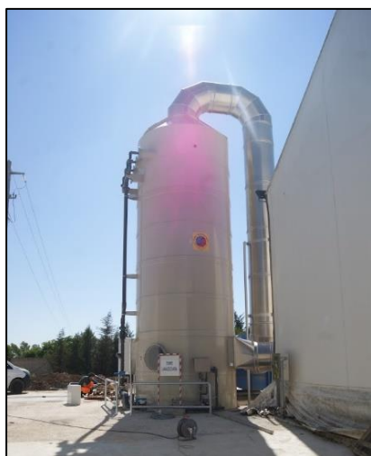
Figura 6: Torre di lavaggio Aria
