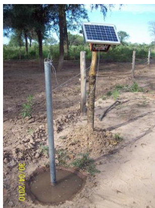
Imagen 30: toma a tierra junto al boyero solar.
