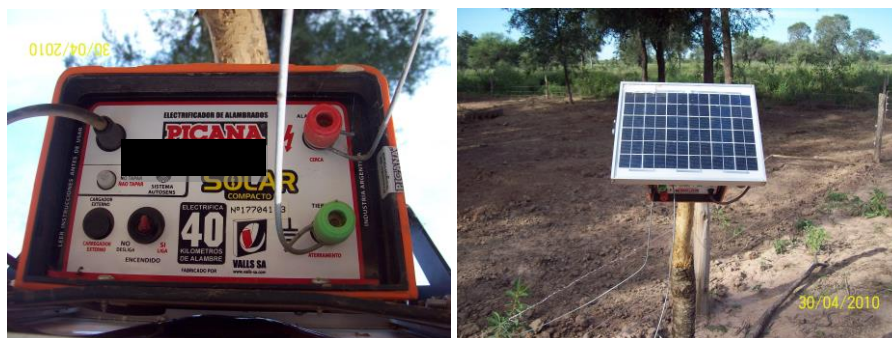
Imágenes 18 y 19: Electrificador con panel solar.
