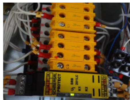
Funcionamento do relé dos botões de emergência e das chaves eletromecânicas
