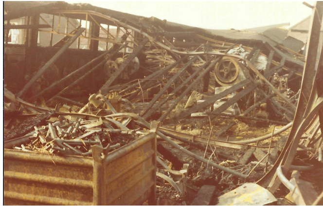
door de hoge temperatuur hebben de stalen profielen hun sterkte verloren en zijn over de machines gezakt FA
