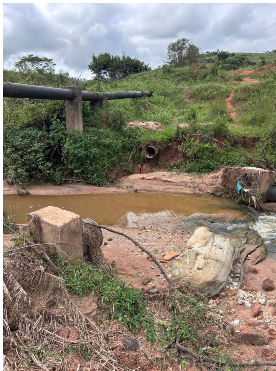
Fotografia 3 - ADUTORA 400MM ROMPIDA, LATITUDE -19.576793°, LONGITUDE -43.192969°.
