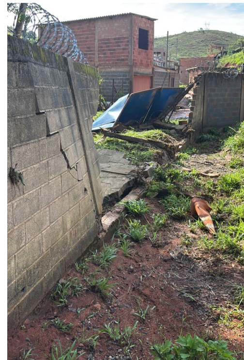
Fotografia 2 - MURO ETA GATOS COLAPSADO LATITUDE -19.584697°, LONGITUDE -43.194373°.
