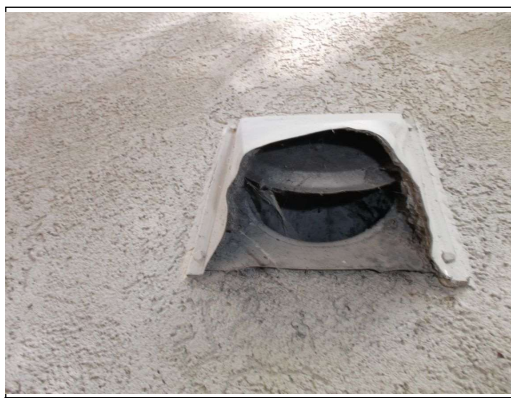
Dryer vent terminal door stuck open
