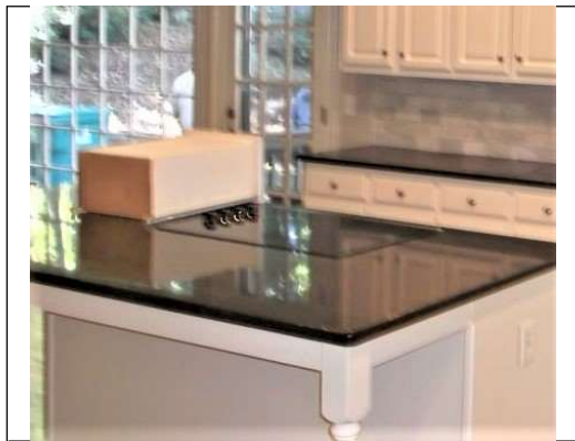
No exhaust fan at cook top
