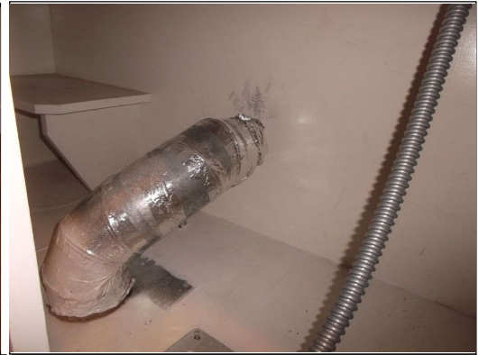
Exhaust fan duct pipe
