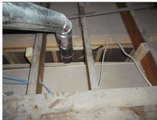
Gas vent pipe touch combustibles
