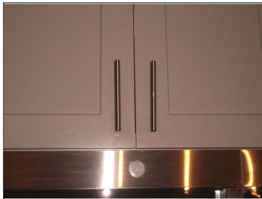
Door handles not level or plumb
