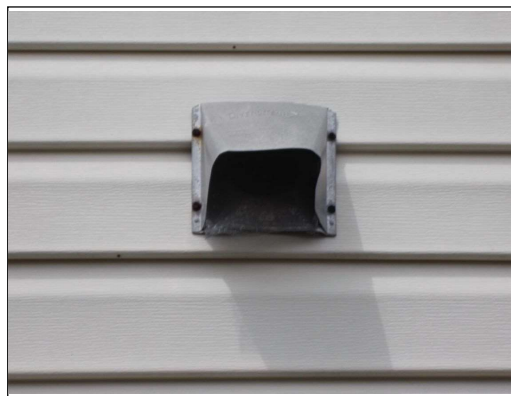
Exhaust vent door missing
