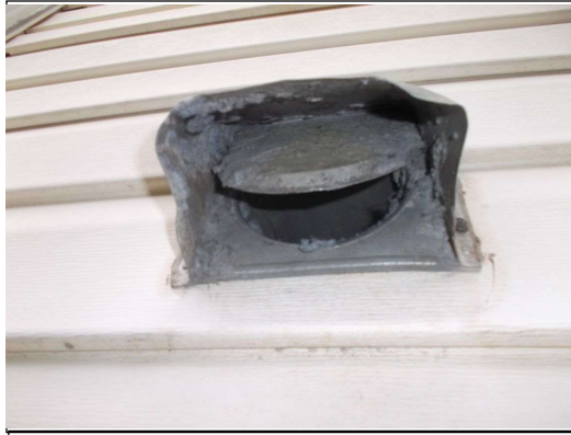
Dryer vent door stuck open
