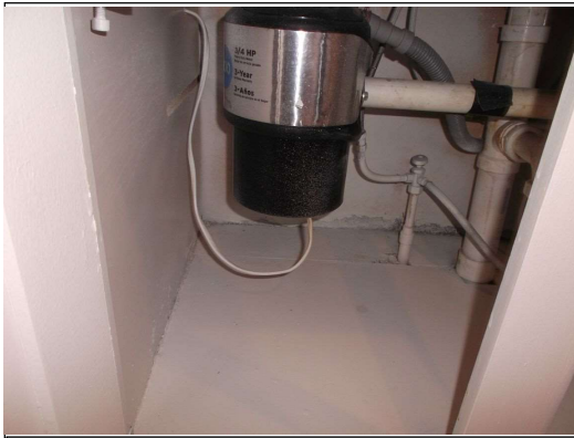
No conduit on disposal cable
