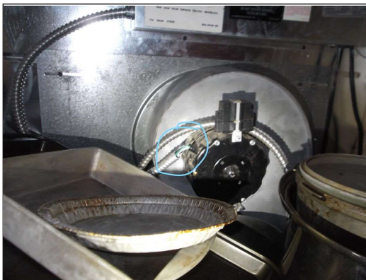
Exhaust fan electrical conduit broken
