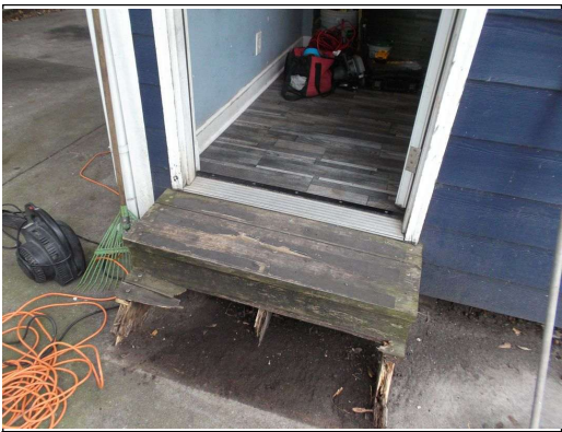
Podredumbre en el marco de la puerta
