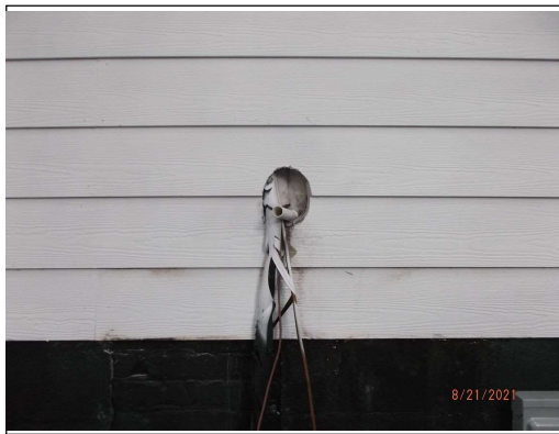
Condensate pipe pour water into wall
