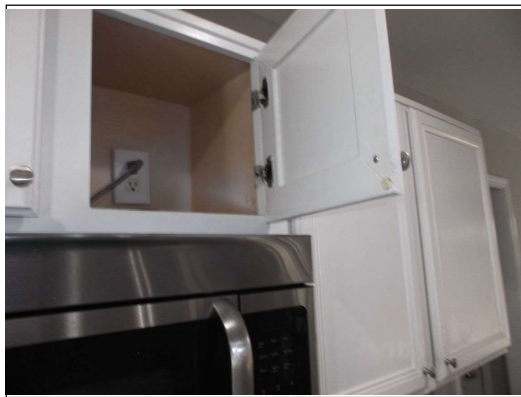
Cabinet door loose
