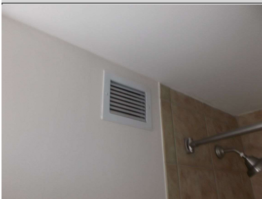
No mechanical exhaust fan
