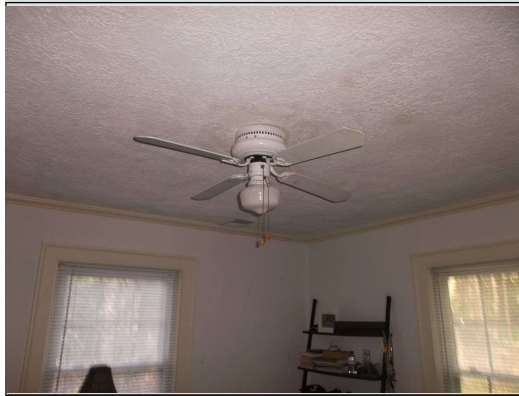
Fan excessive hum
