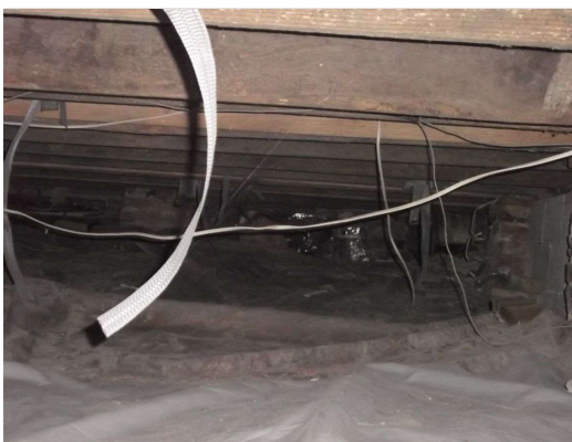
Loose moisture barrier/debris
