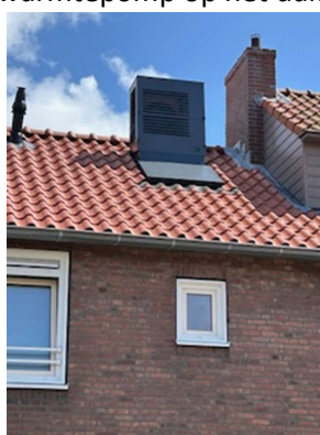
Berghuisstraat met warmtepomp op het dak
