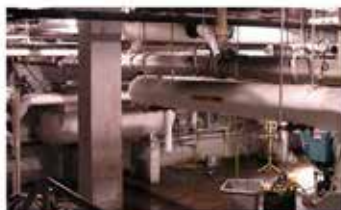
Drenaggio acqua dai locali seminterrati
