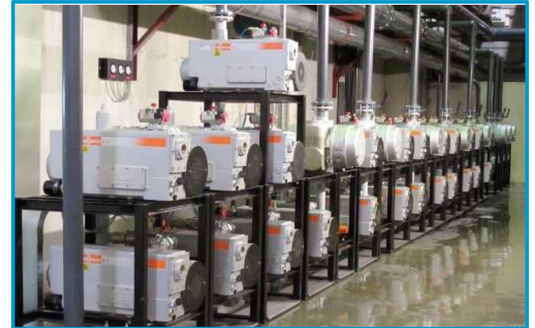
Bombas OIV centralizadas
