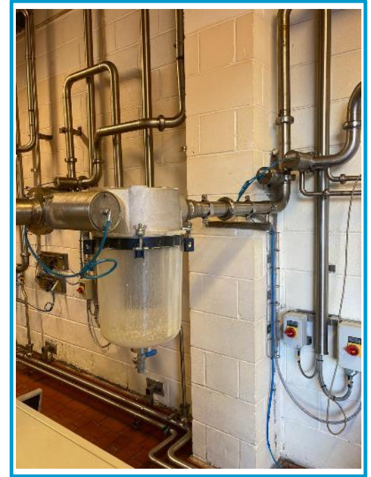
Válvulas de aislamiento CIP y separador de líquidos
