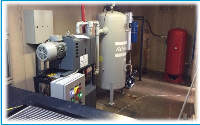
2 x DZS065 instalados en Leopoldo - SP para 48 sillones de dentista
