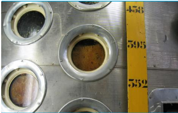
Ventanas de la bandeja del evaporador
