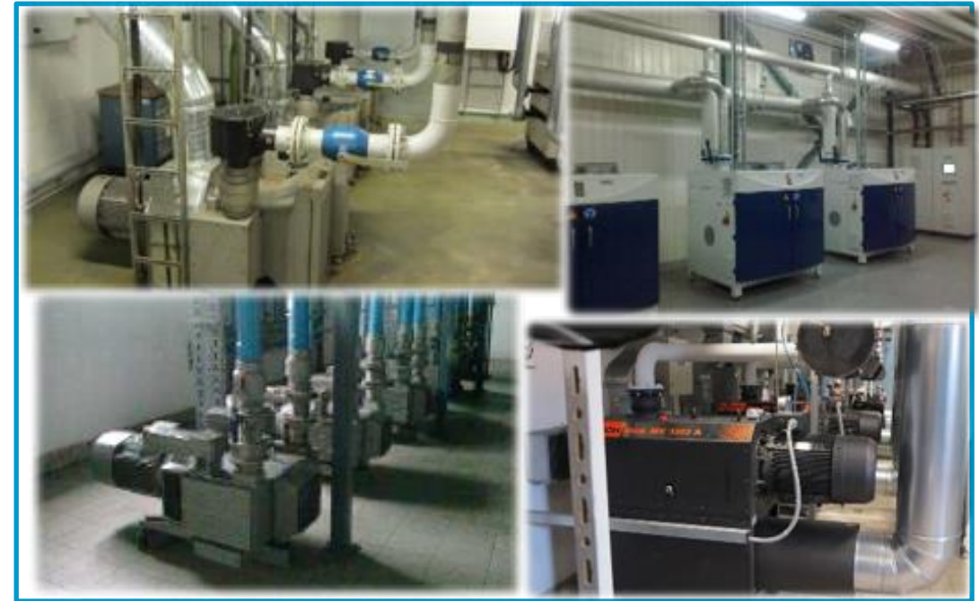
instalaciones competidores – Rietschle
