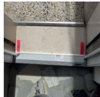
La portafinestra, soprattutto se a due ante, tende ad affondare sul nastro AGP 5037 in corrispondenza dei montanti a causa del loro peso ma a rimanere sollevata nel centro; la soglia forma così una curvatura che può creare difficoltà nella chiusura delle ante. Per risolvere il problema occorre usare negli angoli (vedi le due frecce rosse grosse) degli spessori da 4mm, da rimuovere dopo la posa. Si riempie la fuga che così si è formata con un cordolo di MS polimero.
