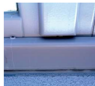
La rottura del cordolo di silicone sia nella parte interna che esterna ha consentito il passaggio di vapore che si è condensato all'esterno della finestra.
