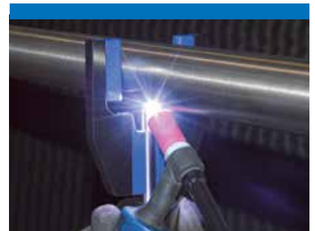
Setzen der Schweißpunkte. Fissare il corrimano con punti di saldatura sul montante.
