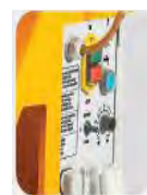
Cuadro eléctrico con salidas auxiliares bajo voltaje.
