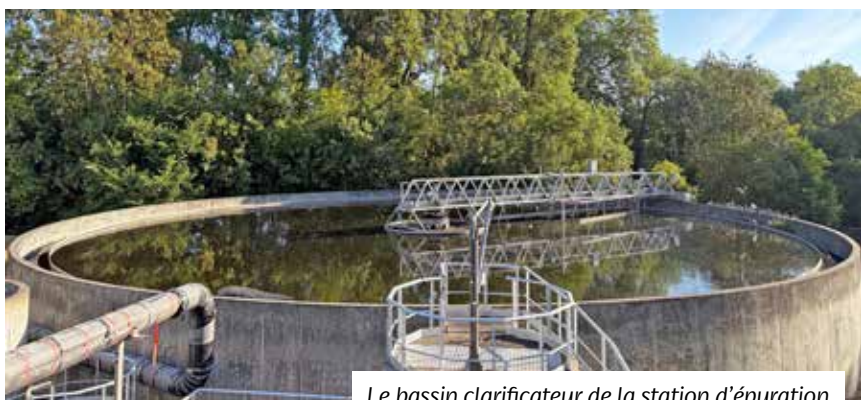
Le bassin clarificateur de la station d'épuration
