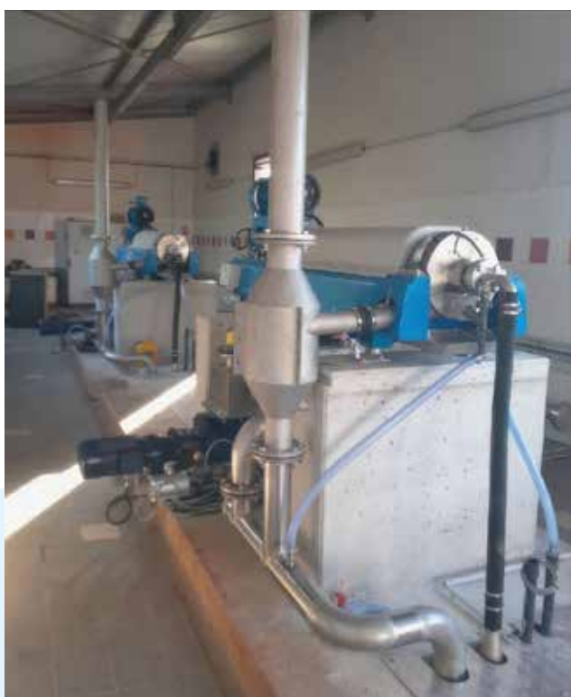
Installation des deux centrifugeuses
