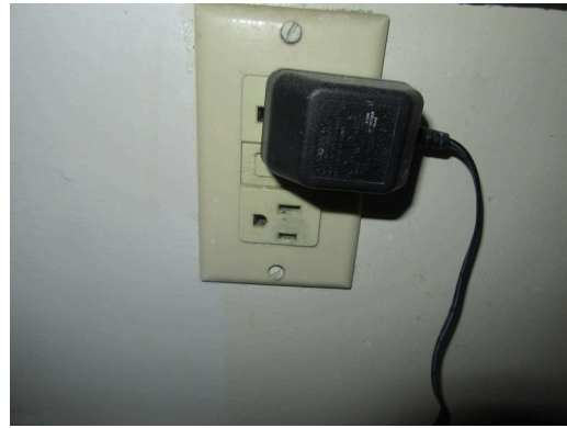
MEP - 72 GFCI outlet
