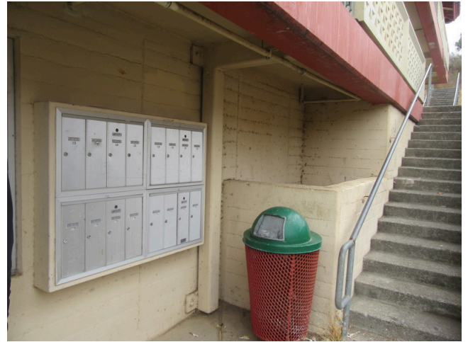
30. Exterior - Tenant mail boxes
