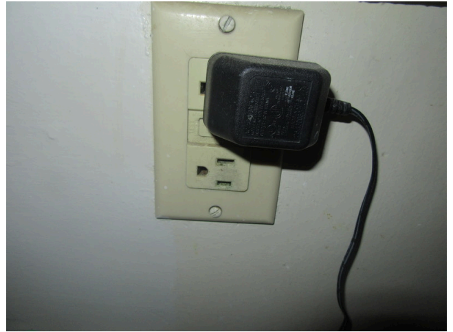
54. MEP - 72 GFCI outlet
